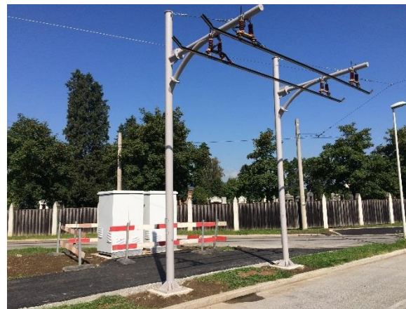
Ladeleistung Zentralfriedhof: 400 kW
