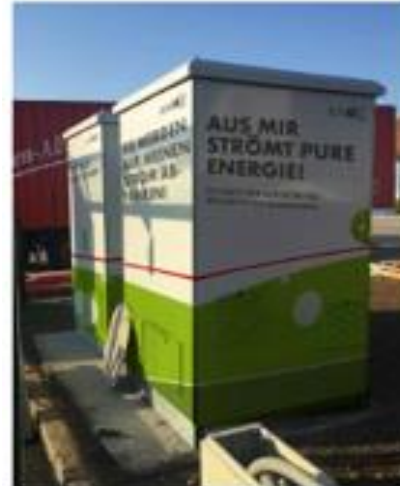
Ladeleistung City Park: 375 kW
